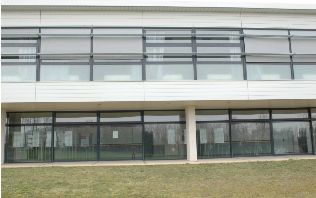
Fig. 2.7. Exemple d'une image avec distorsion, très nettement visible sur le haut du bâtiment (bâtiment de l'ESGT, Le Mans).
