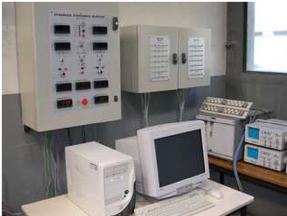
FIG. 6.11 – Salle de contrôle
