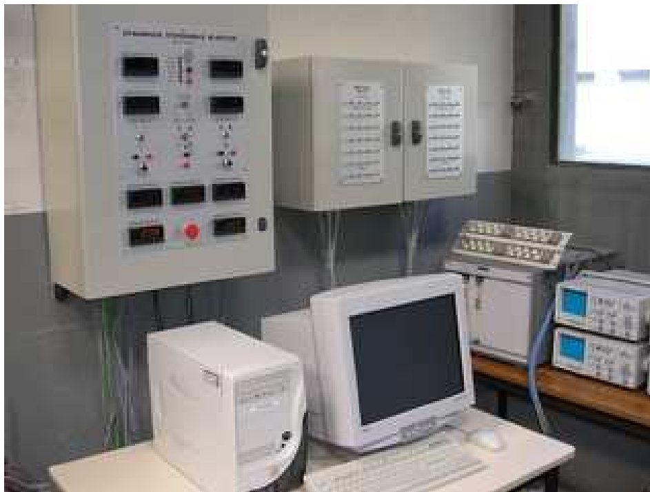
FIG. 6.11 – Salle de contrôle
