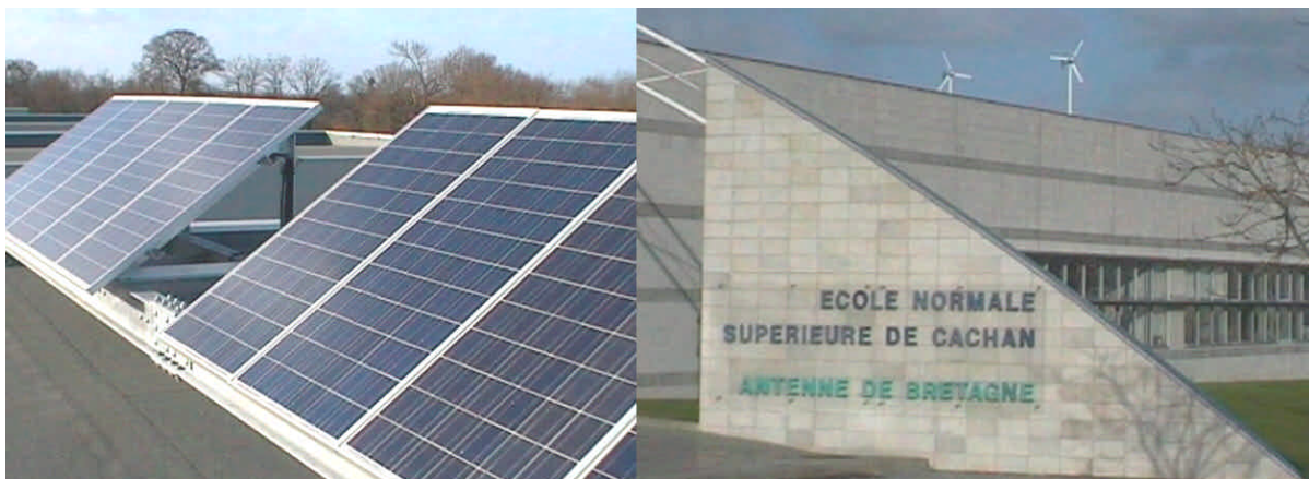
Système expérimental éolien-photovoltaïque (1,5 kW et 2 kW) couplé au réseau et associé à 15 kWh de batteries.
