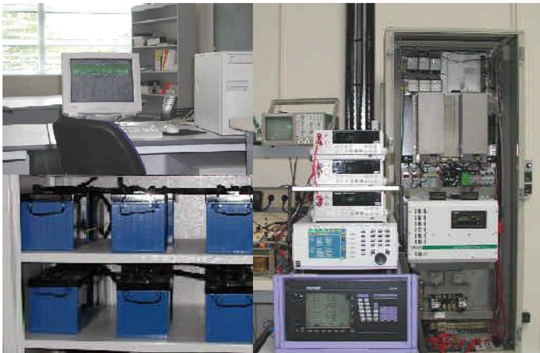
Centrale d'acquisition, accumulateurs électrochimiques et armoire électrique.
