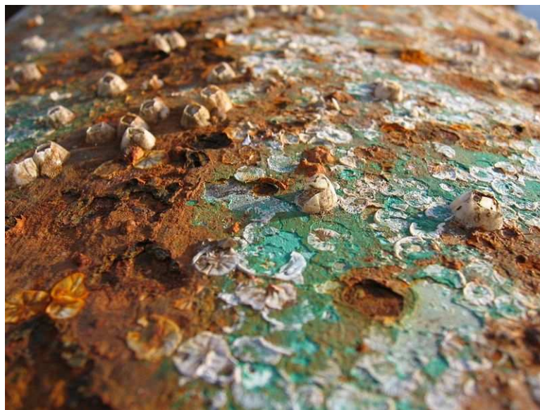
Figure II.11. Exemple de métal ayant subi une forte corrosion en milieu marin oxygéné (avec de plus un phénomène de corrosion caverneuse sous les coquillages) (Auteur : Rafal Konkolewski)
