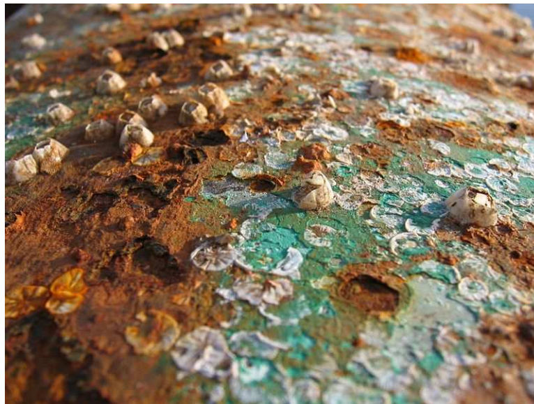
Figure II.11. Exemple de métal ayant subi une forte corrosion en milieu marin oxygéné (avec de plus un phénomène de corrosion cavernreuse sous les coquillages) (Auteur : Rafal Konkolewski)
