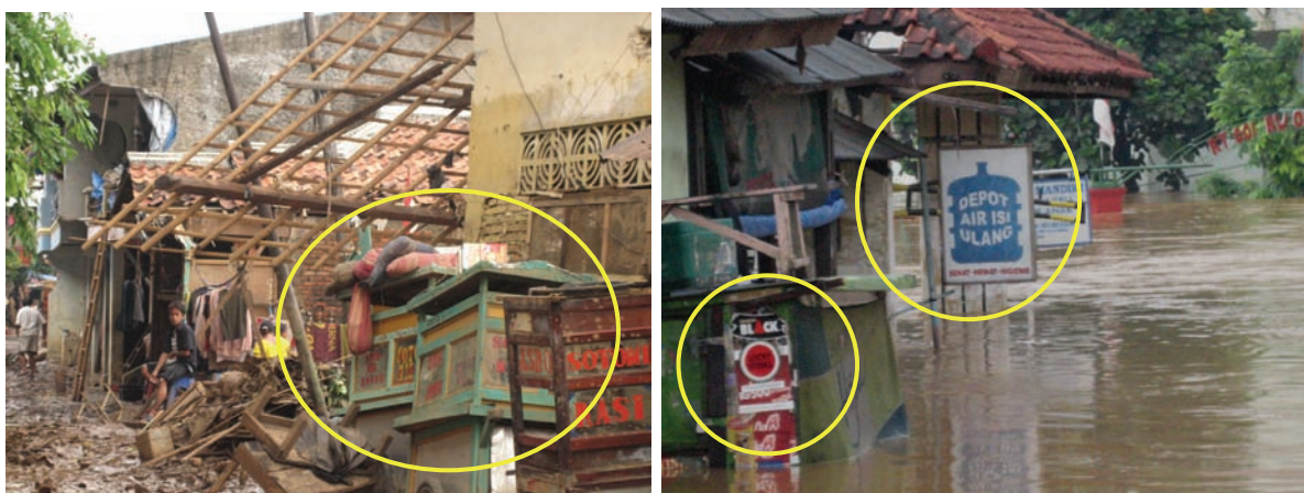
Figure 4.40. Petits commerces informels endommagés (à gauche : kaki lima endommagés ; à droite : petit warung et point de vente d'eau assainie artisanalement ne pouvant fonctionner à cause des inondations à Bukit Duri (clichés P. Texier, 6 et 4 février 2007).
