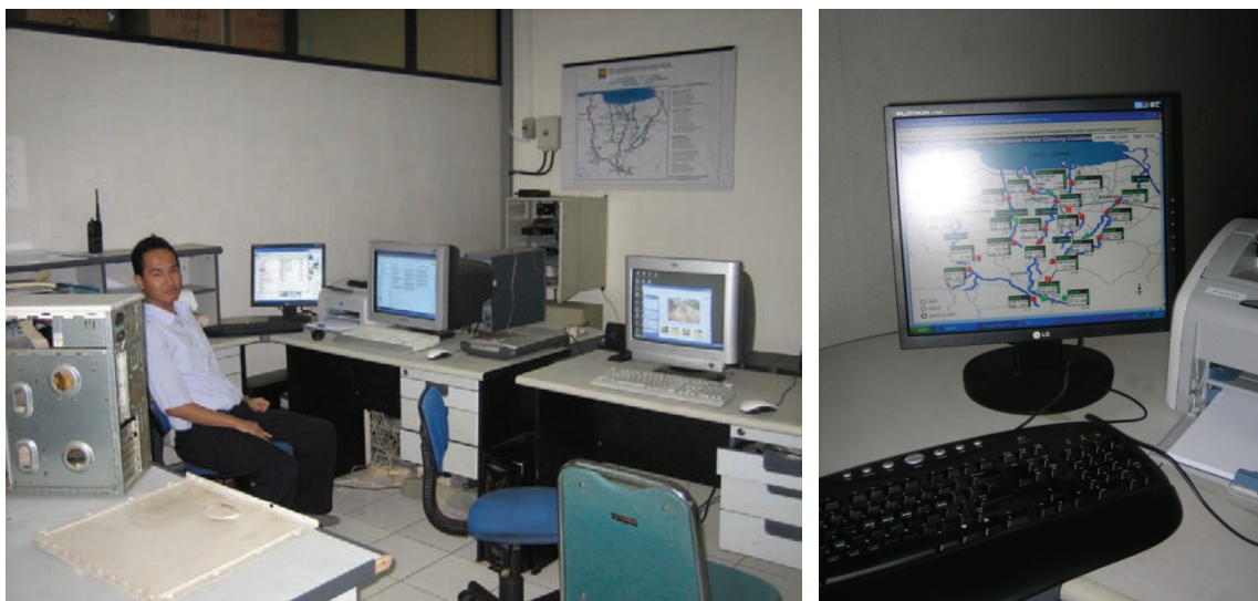
Figure 6.7. Centre télémétrique de surveillance des précipitations et des débits (Poste d'astreinte radio, point de départ de l'Early Warning System ou alerte précoce) au PWS Ciliwung Cisadane Project , à Cawang (Jl Kalimalang). (Clichés P. Texier, février 2007).
