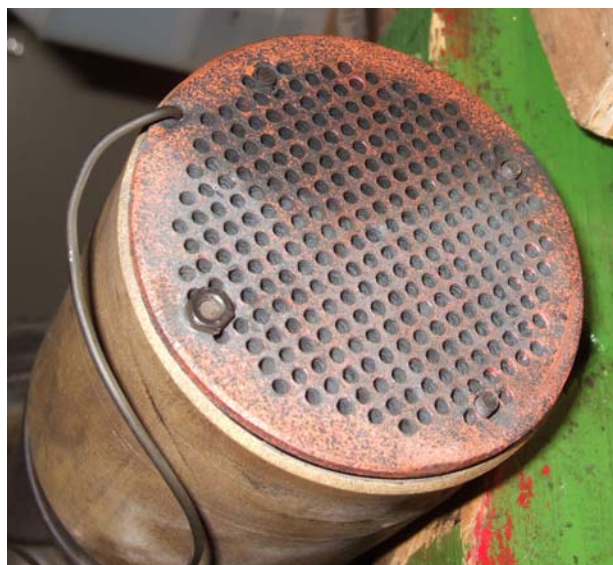
Figure 4 : Vue extérieure de l'échangeur chaud déposé
