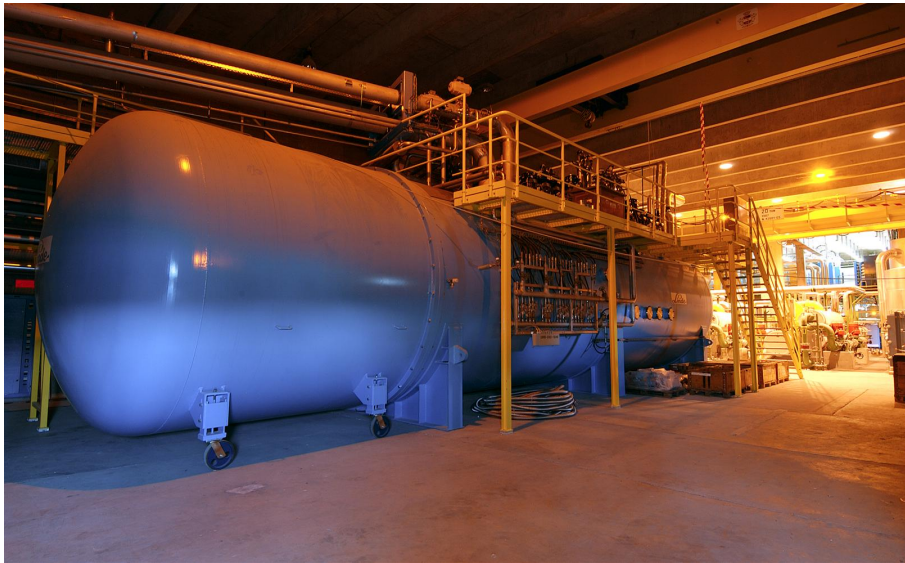
FIGURE 4.21 – boîte froide 18 kW à 4,5 K pour le LHC (Linde)
