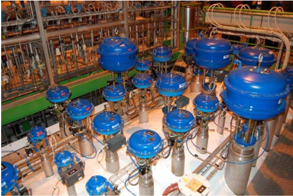
FIGURE 3.10 – Têtes de vannes sur une boîte froide du LHC
