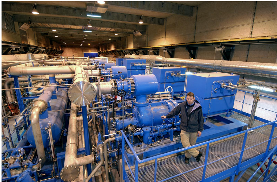
FIGURE 4.17 – Station de compression chaude pour le LHC
