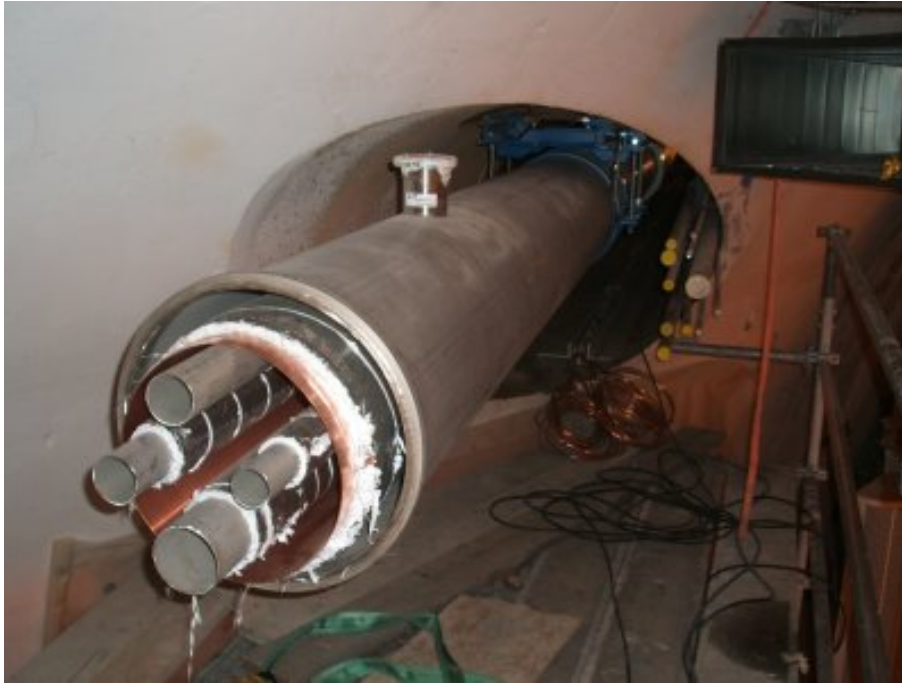
FIGURE 3.5 – Ligne de transfert cryogénique
