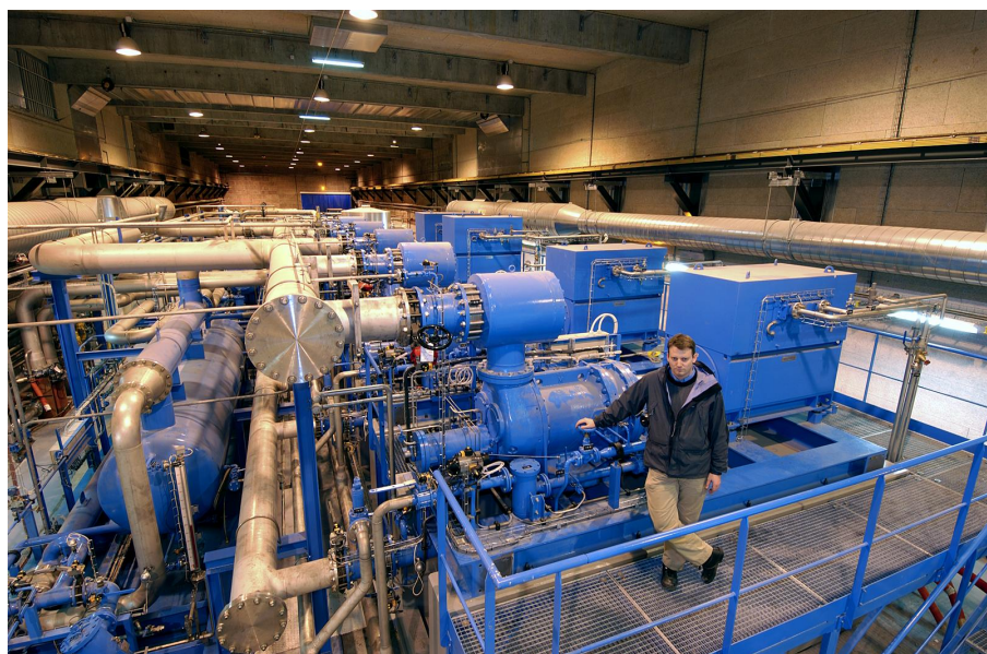
FIGURE 4.17 – Station de compression chaude pour le LHC
