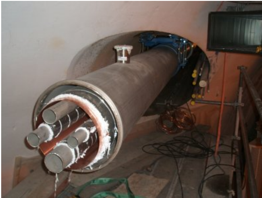
FIGURE 3.6 – Ligne de transfert cryogénique
