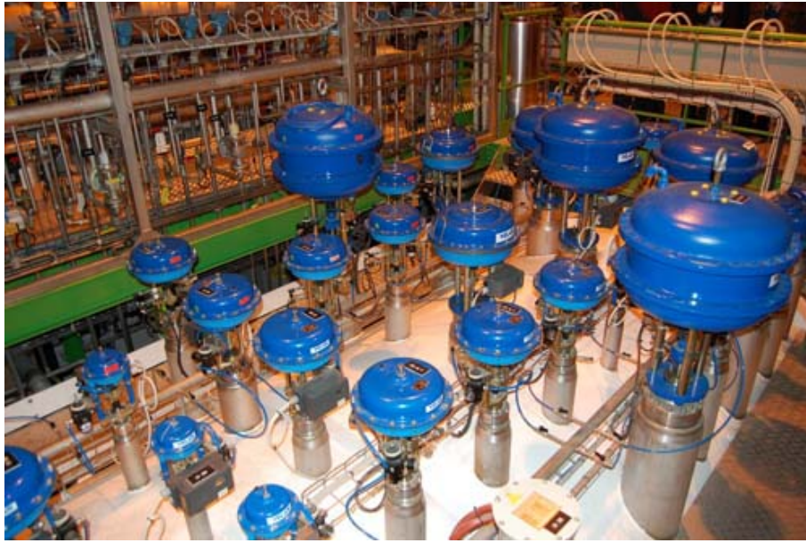
FIGURE 3.10 – Têtes de vanne sur une boîte froide du LHC
