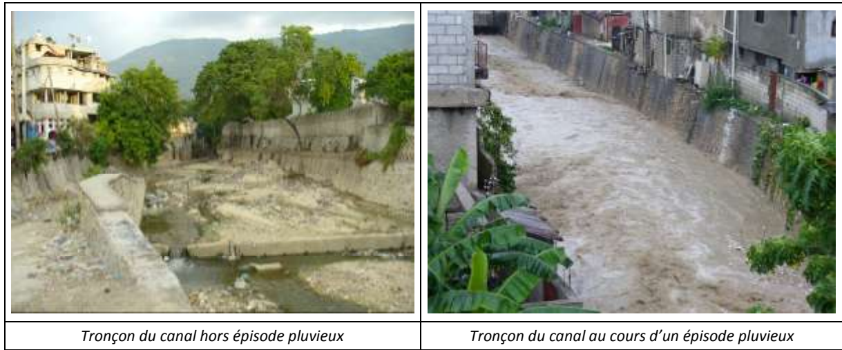
Figure 54 : Scénario haïtien - Vues du Canal Bois-de-Chêne à Port-au-Prince hors épisode pluvieux et au cours d'un épisode pluvieux (photos : Angerville, 2008)
