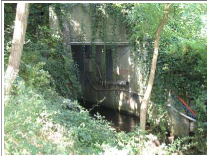
Figure 53 : Scénario français - Déversoir d'orage (DO) déversant des RUTP dans la rivière Chaudanne
