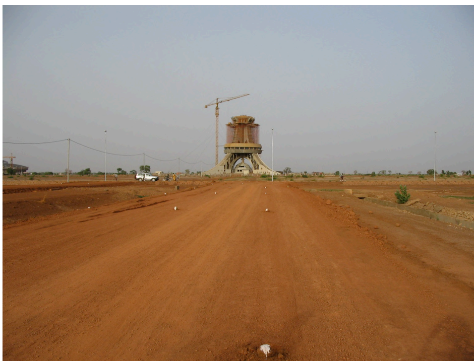
Photo 19 : Le monument aux héros nationaux en construction et la future voie à goudronner – Ouaga 2000 – Juin 2005.
