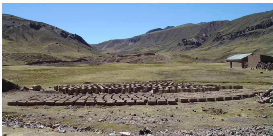
Photo 61 – Faenas organisées par la communauté de Llanca pour construire une chapelle, un local de stockage et de réunion (juin 2007)
