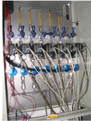
Figure 3 Armoire du contrôle de débit des voies de gaz
