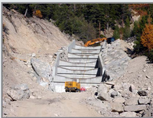
19/10/2008: Mise en place de deux caissons stabilisateurs dans la section supérieure du Grand Verdarel. Source: SGMB.
