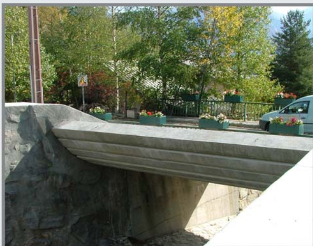
10/10/2007: "casquette" en béton armé sur le pont des Neyzets. Source: L. Thénard.
