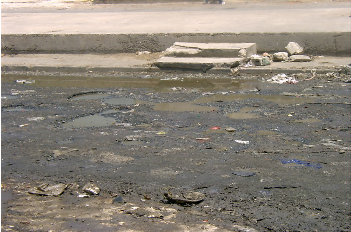
Photo 65. Eaux ménagères jetées à même la chaussée à la Médina. Le contact prolongé de l'eau avec l'infrastructure, entraîne sa dégradation progressive. (Cliché DIAWARA A-B 2007)
