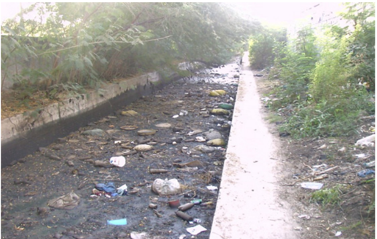
Photo 70. Eaux usées, détritiques et déchets liquides industriels. Ce canal d'évacuation des eaux de pluie se déverse dans la baie de Hann. (Cliché DIAWARA A-B 2007).
