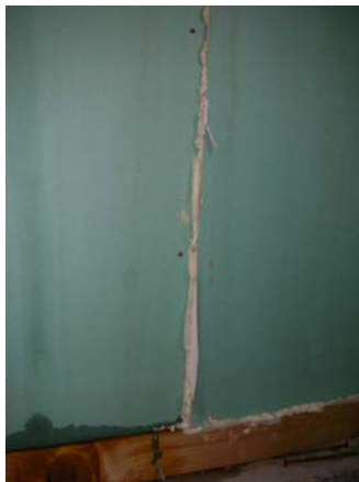
Figure 2.8 : L'isolant entre les plaques de BA-13 n'a pas été posé correctement (risque de déperditions élevées)
