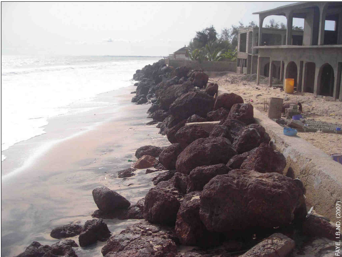
Photo 49 : Enrochement protégeant une résidence secondaire en construction au sud de Siendou. Photo prise en direction du nord, le 05-08-2007.
