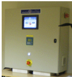
(d) Automatic control unit
