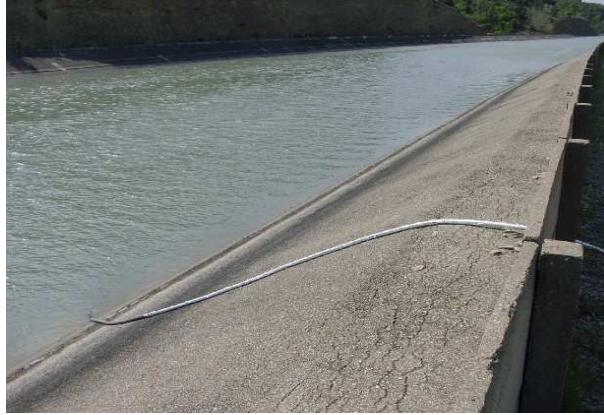
(a) Prise d'eau du canal
