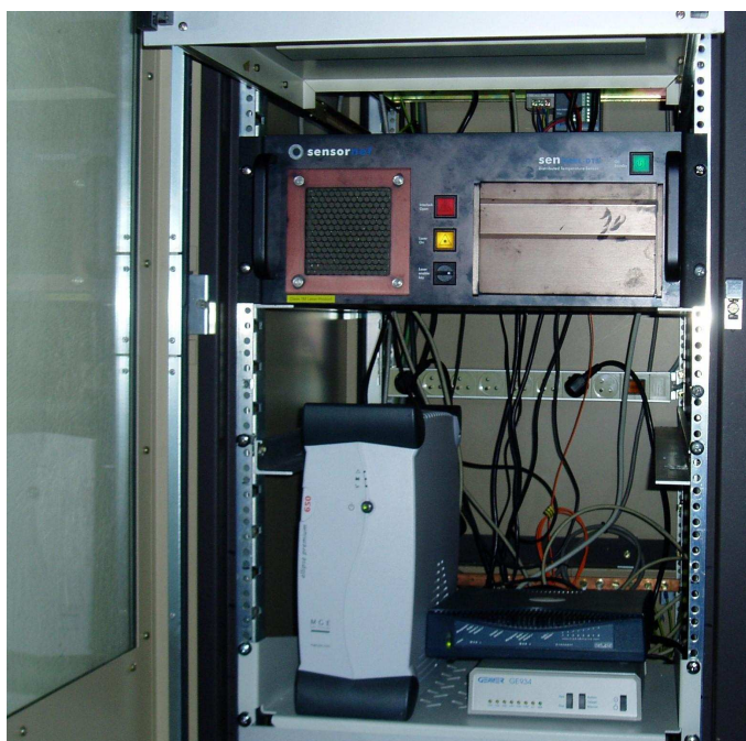
Fig. 1.11: Installation typique de DTS Sensornet pour acquisition des mesures thermométriques.
