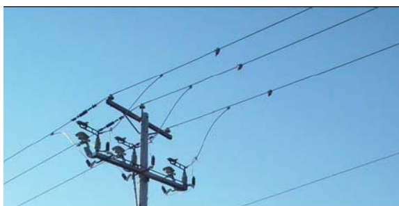
Figure 1.5 : interrupteur HTA sans pouvoir de coupure installé sur un pylône
