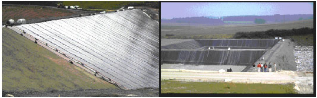
fig. 2.4. DEG dans un centre de stockage de déchets (d'après [Bri01]).
