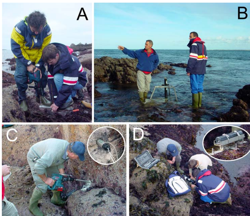
Photo 30. Campagne d'installation des capteurs de pression et des courantomètres. A : mise en place des supports en inox. B : courantomètre acoustique - ADV Nortek. C : capteur de pression de hauteur d'eau - HOBO data logger Water Level U20. D : capteur de pression de houle et de marée - Wave Gauge OS I-010-003B (Ocean Sensor Systems).
