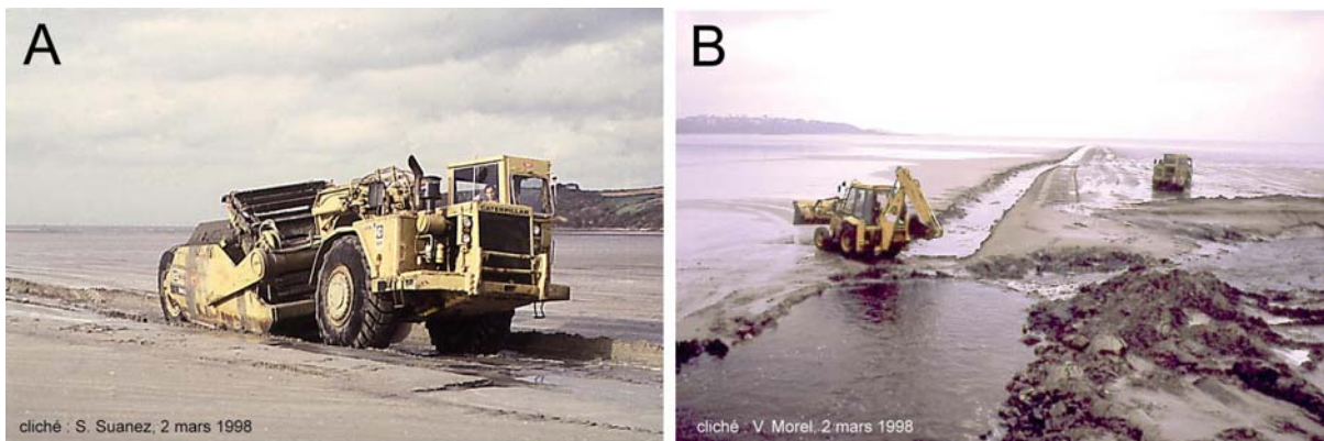
Photo 17. Travaux de rectification du tracé des cours d'eau du Yar et du Roscoast. A : ouverture du chenal artificiel du Yar à l'aide d'un engin de type "éplucheur". B : connexion entre le débouché du Yar et le chenal artificiel.
