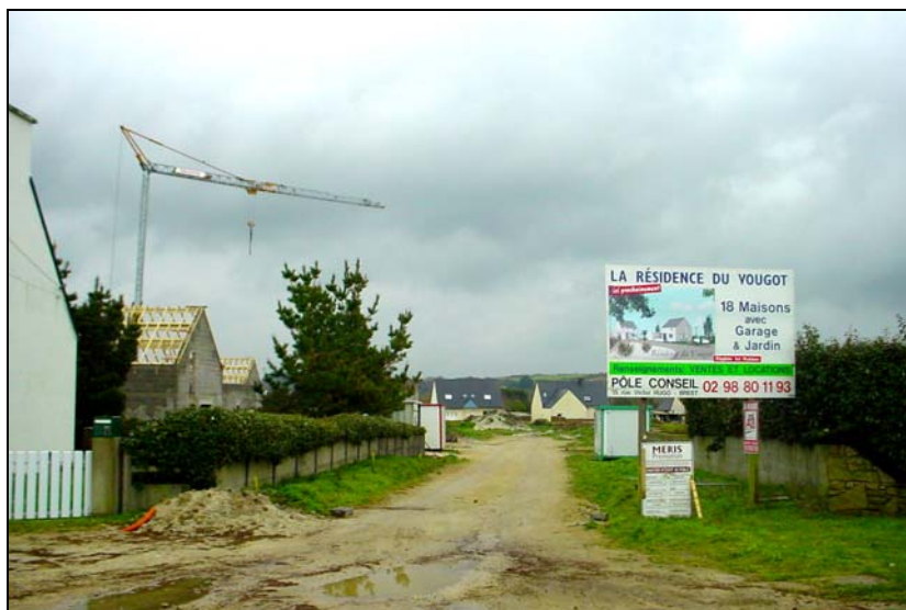
Photo 22. « La résidence du Vougot » constituée d'un lot de 18 maisons en cours de construction à l'arrière du cordon dunaire dans la zone potentiellement inondable (photo S. Suanez, 22/03/2007)
