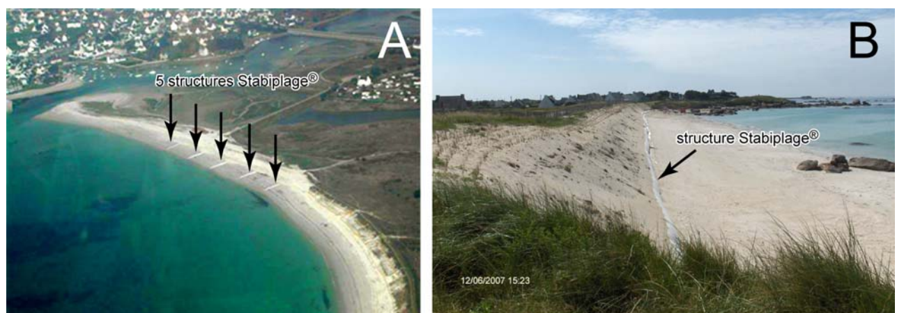
Photo 25. Vue aérienne des 5 Stabiplate ® transverses mis en place sur la plage des Sables Blancs (A). Vue oblique du Stabiplate ® longitudinal installé en pied de dune de la plage de Boutrouilles (B) (cliché : Espace Pur).
