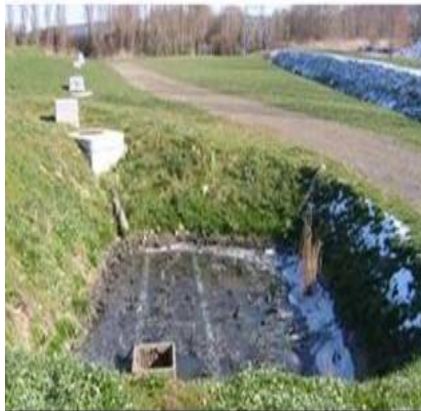
FIGURE 1 Casier à tourbe de la station d'épuration de Honfleur (France, 2005).
