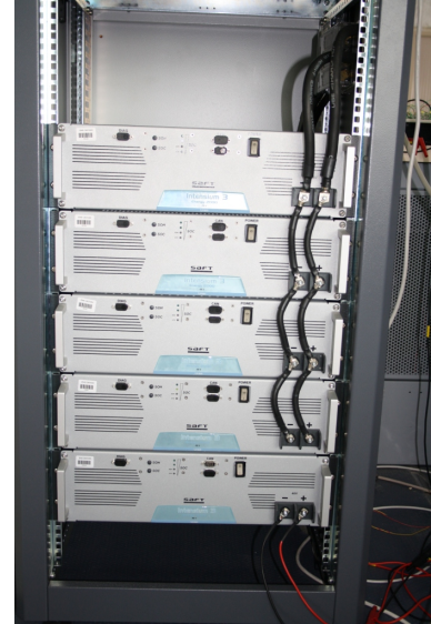
(b) 10 kWh de stockage Li-ion
