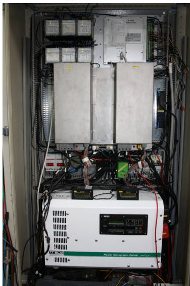
(c) Convertisseurs statiques : onduleur et hacheurs MPPT
