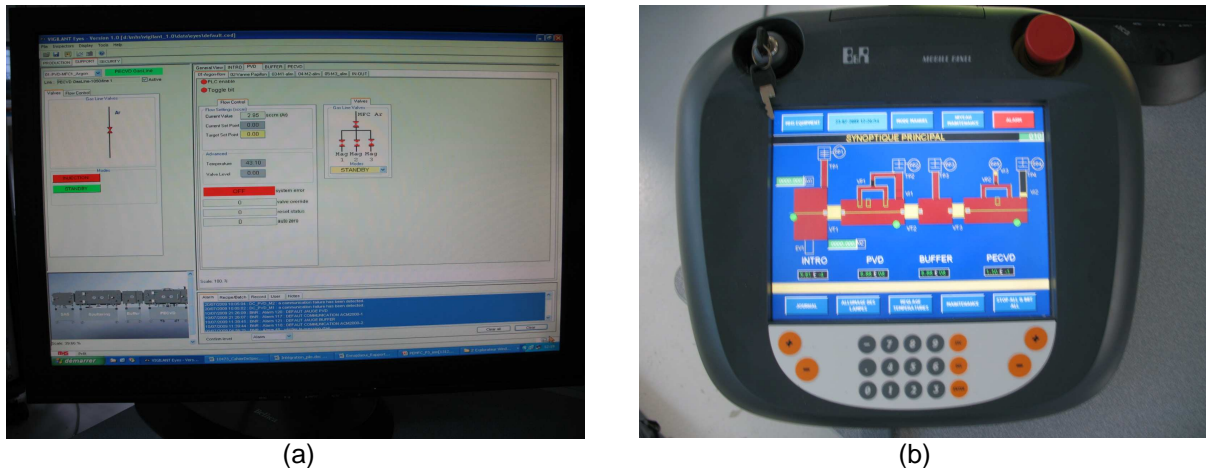
Figure 68 : (a) Photo de l'écran de la supervision avec l'application « Eyes » ouverte sur le support pulvérisation/gestion du flux d'argon ; (b) Automate à écran tactile sur le synoptique général de P3.
