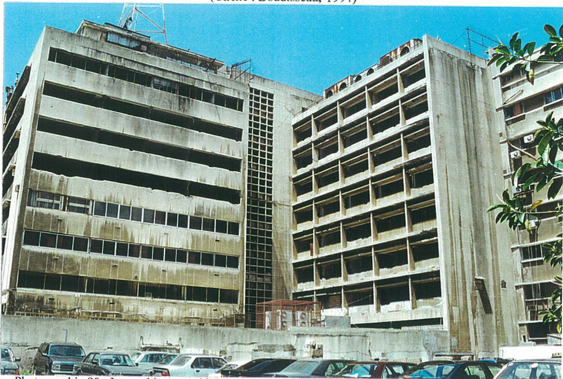
Photographie 80 : Immeuble (ex Arida) dégradé après l'occupation des réfugiés, vu de dos, rue Hamra (Cliché : Boudisseau, 2001)
