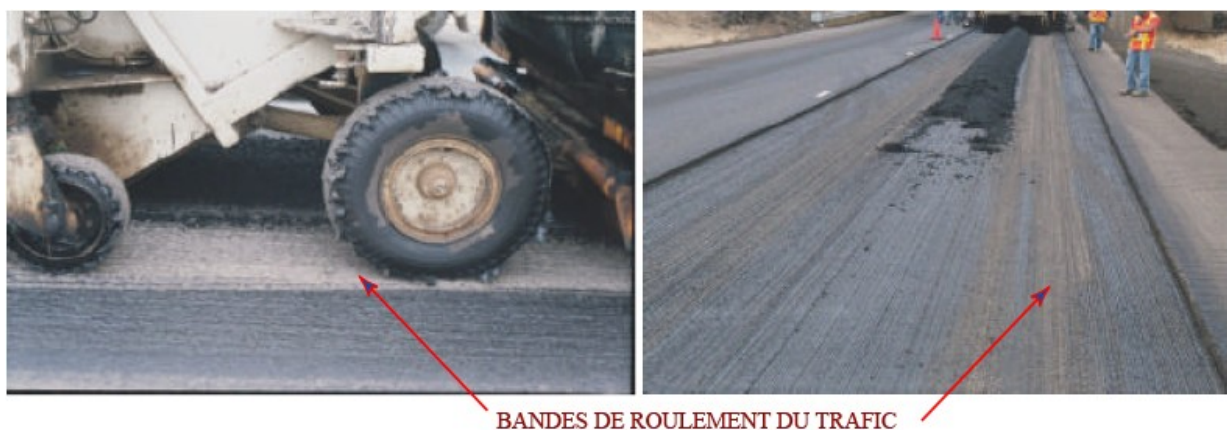
Figure I.4-3. « Départ » de la couche d'accrochage au niveau des bandes de roulement [WES 03]
