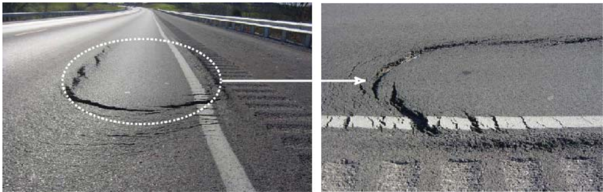
Figure I.4-2. Exemple de dégradation due à un défaut de collage à l'interface [BUC 04]
