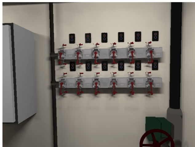
Ensemble de vannes
