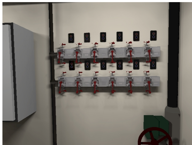
Ensemble de vannes
