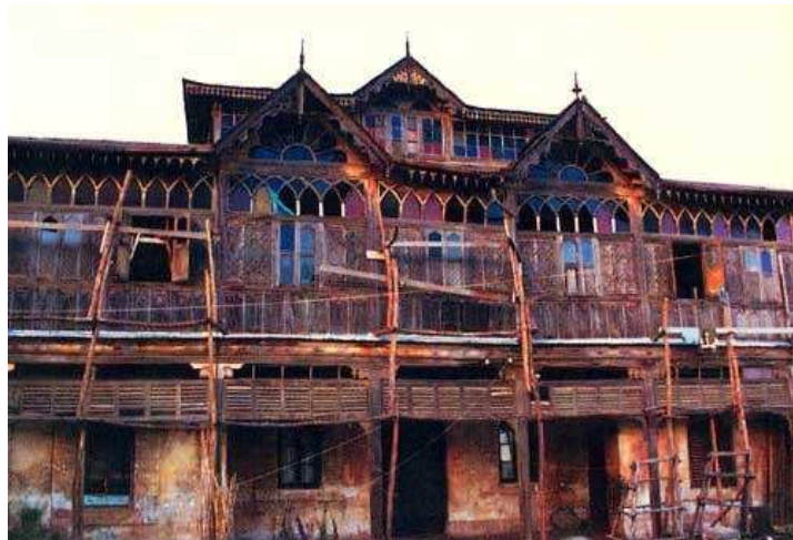
Photo 15 : La maison Rimbaud avant sa restauration (Harar, 2000)
