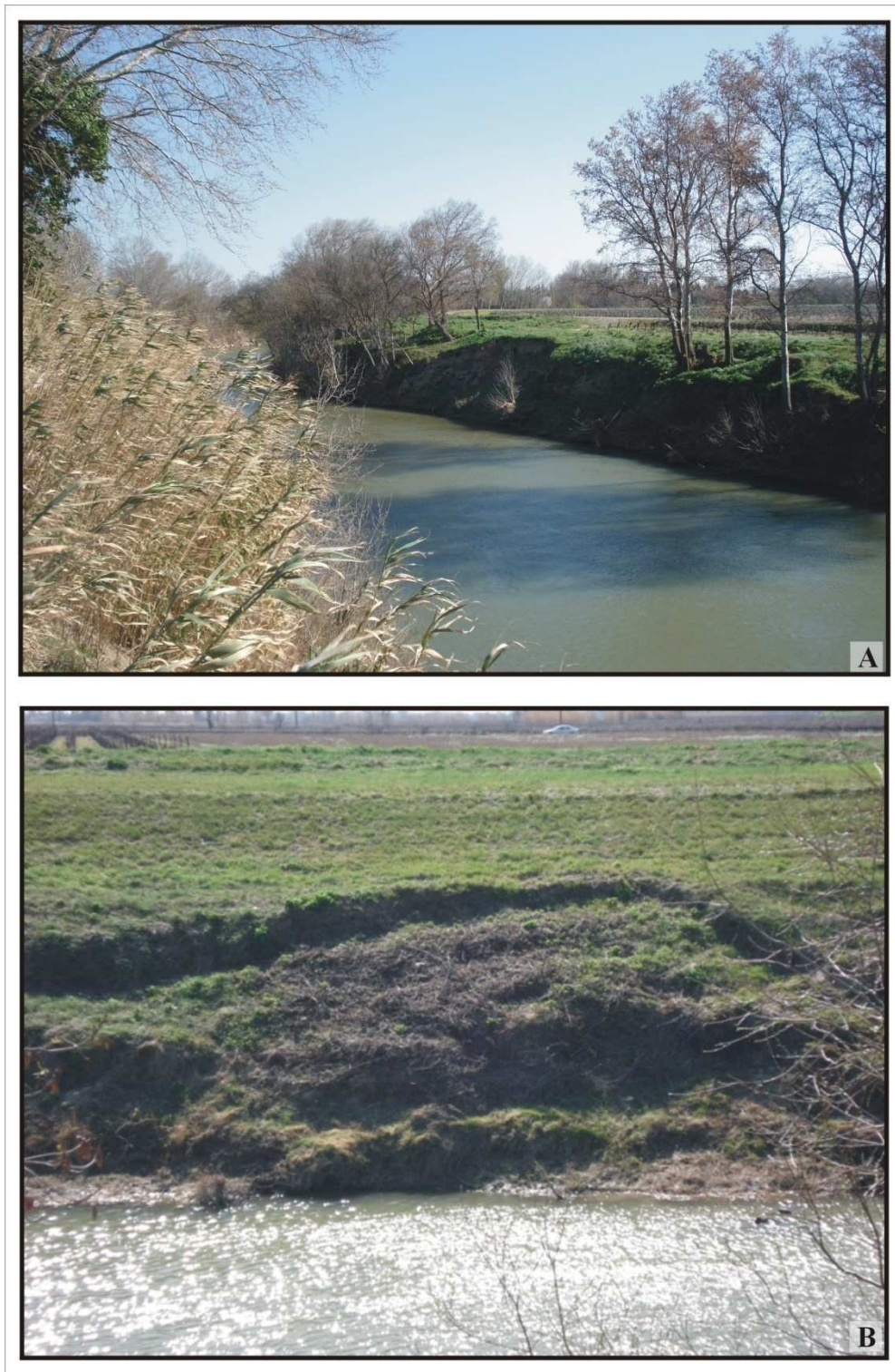
Photographie 6.3 : Irrégularités et affouillement des digues en terre (Clichés S. Defossez, 2006)
