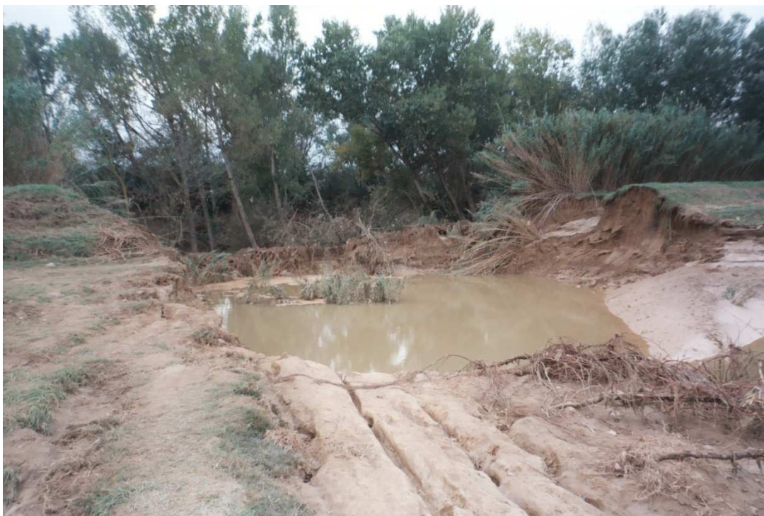
Photographie 5.4 : Brèche dans une digue à l'aval de Cuxac-d'Aude suite aux crues de novembre 2005 (Cliché : F Vinet, novembre 2005)
