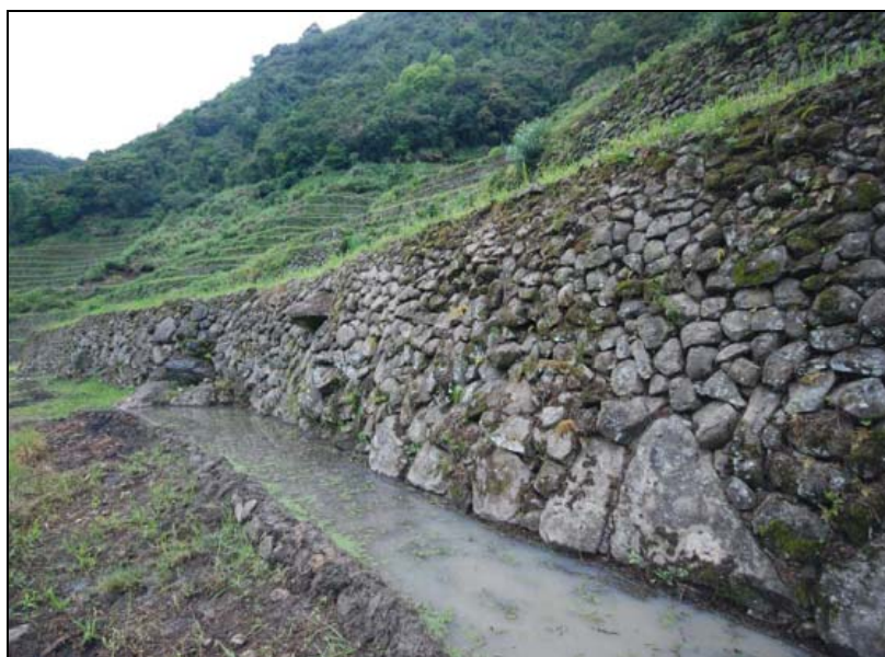
Photo 6.2. Retenue d'eau en vue de réparer le mur de la terrasse du dessous à Batad (Banaue, avril 2008).
