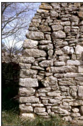
Photo 7.4. Mur qui « fait ventre », déformé par la poussée des terres au Pont-de-Monvert (octobre 2007).
