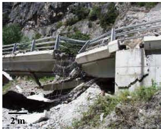
Figure 1-11 : Destruction de l'une des piles de pont suite à l'écroulement de Mai 2000, d'après Gunzger et al., 2003 (modifié)
