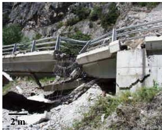
Figure 1-11 : Destruction de l'une des piles de pont suite à l'écrasement de Mai 2000, d'après Gunzger et al., 2003 (modifié)
