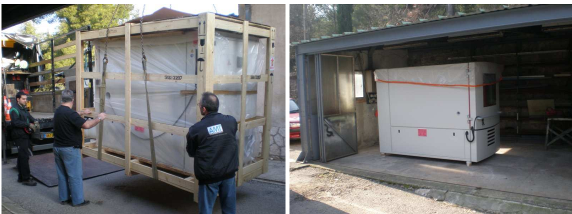
FIGURE 7.31 – Installation de l’enceinte thermique au Mont Gros à Nice. Cette enceinte permet de tester les éléments du télescope sous les températures du Dôme C.
