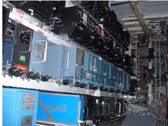
figure I.19 : installation de différents calculateurs dans la soute avionique sur A320
