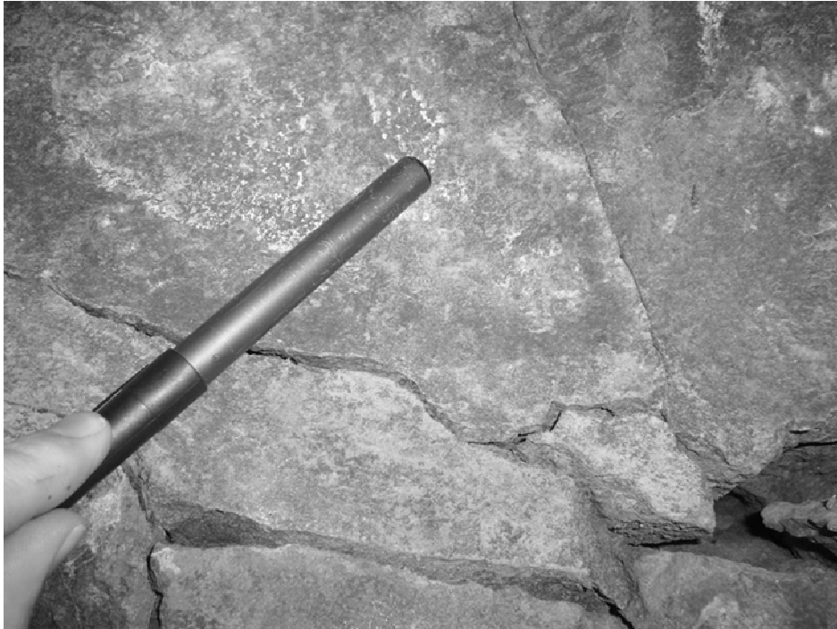
Coulée des Grosliers : fissuration
