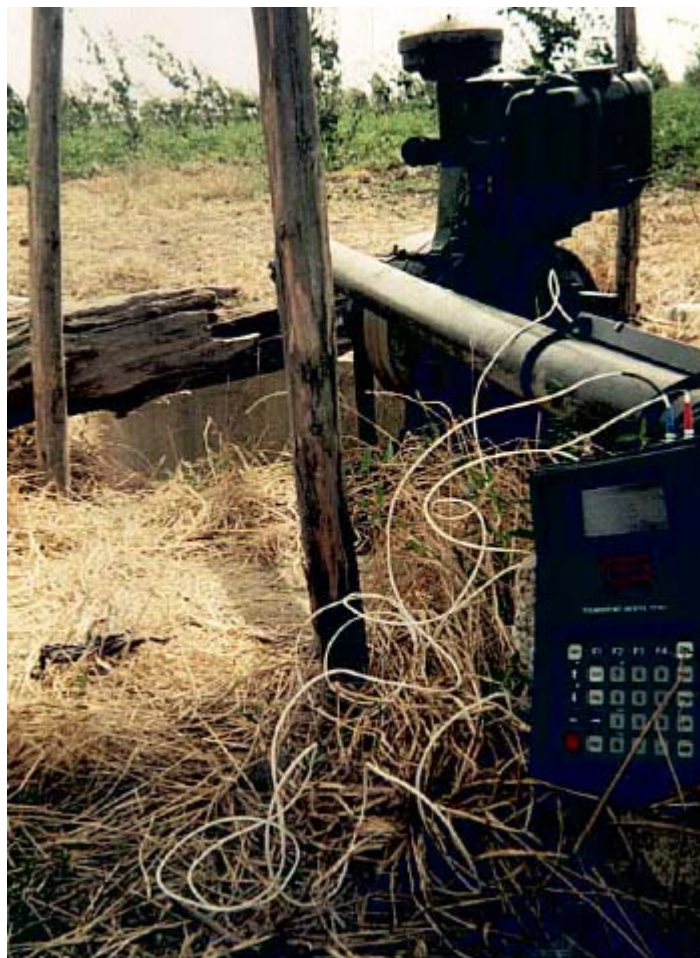
Figure 8- 4 - Mesure de débit par débitmètre à ultrasons en sortie d'une pompe de 6 chevaux couplée par une courroie à un moteur diesel de 8 chevaux
