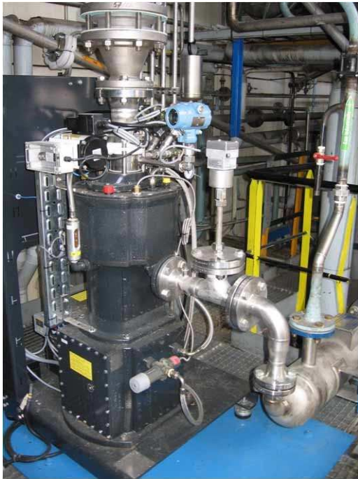
FIGURE 66. PHOTO D'UNE POMPE SECHE
