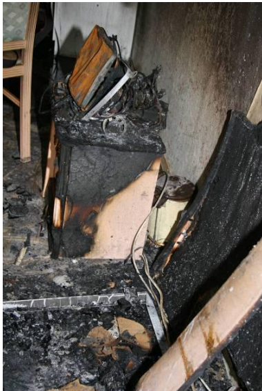
422. Téléviseur fortement détruit placé sur la table de nuit accolée au lit
