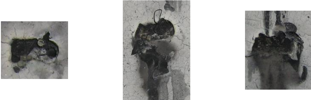
365. Photos après l'essai des interrupteurs disposés dans la chambre correspondant de gauche à droite aux matériels placés respectivement du plus haut au plus bas sur le mur
