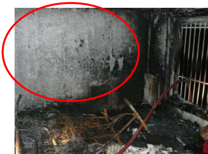
196. Illustration de la dégradation de suies déposées sur les parois
