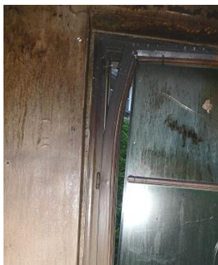
9. Déformation d'une fenêtre suite principalement à l'action des gaz chauds
