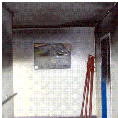
322. Puzzle disposé dans la circulation horizontale commune à la sortie de l'appartement sinistré
