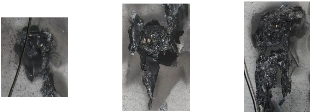
366. Photos après l'essai des prises de courant disposées dans la chambre correspondant de gauche à droite aux matériels placés respectivement du plus haut au plus bas sur le mur
