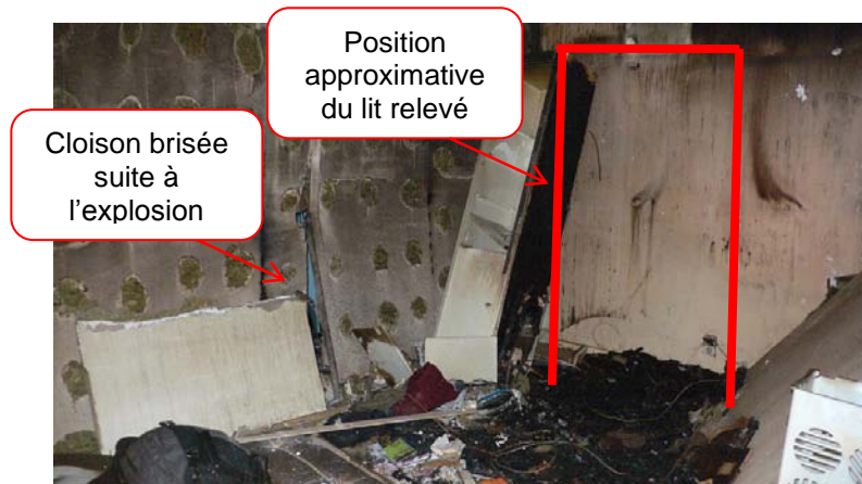
8. Vue de l'emplacement du lit à l'origine du sinistre
