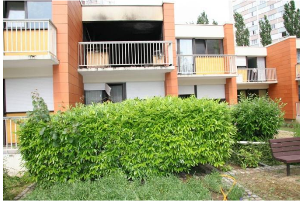
291. Vue extérieure du bâtiment et de l'appartement sinistré au rez-de-chaussée haut
