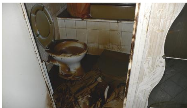
10. Dépôt sur toutes les surfaces des imbrûlés de la combustion du matelas
