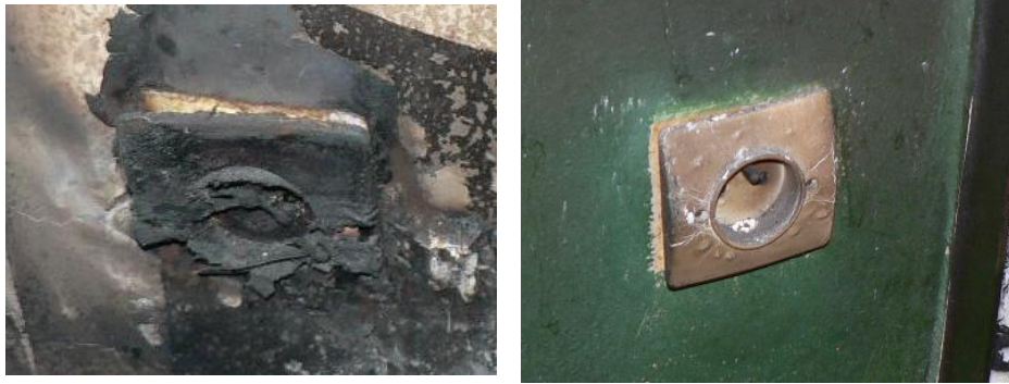
207. Prise de courant ayant subi les effets d'un incendie
