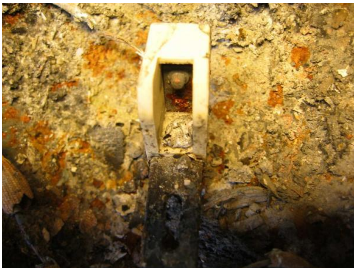
406. Vasque fortement corrodée
