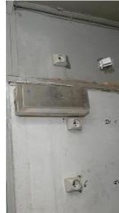
220. Disposition des prises de courant, interrupteurs et bloc autonome de sécurité sur le palier de l'appartement
