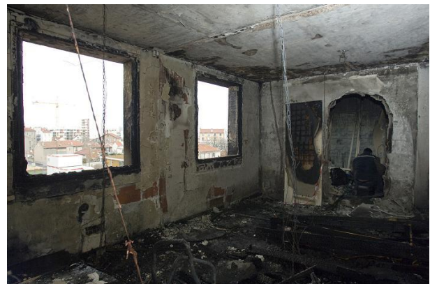
22. Vue de la chambre après l'essai pour lequel l'embrasement généralisé est atteint
