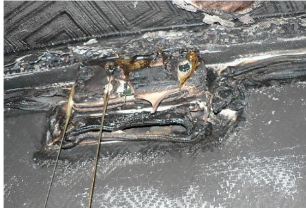
209. Dégradation d'un bloc autonome d'éclairage de sécurité pris dans un incendie
