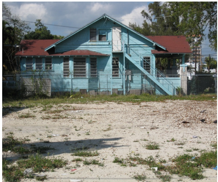
Photo 9 : Habitat traditionnel dégradé et lot vacant
