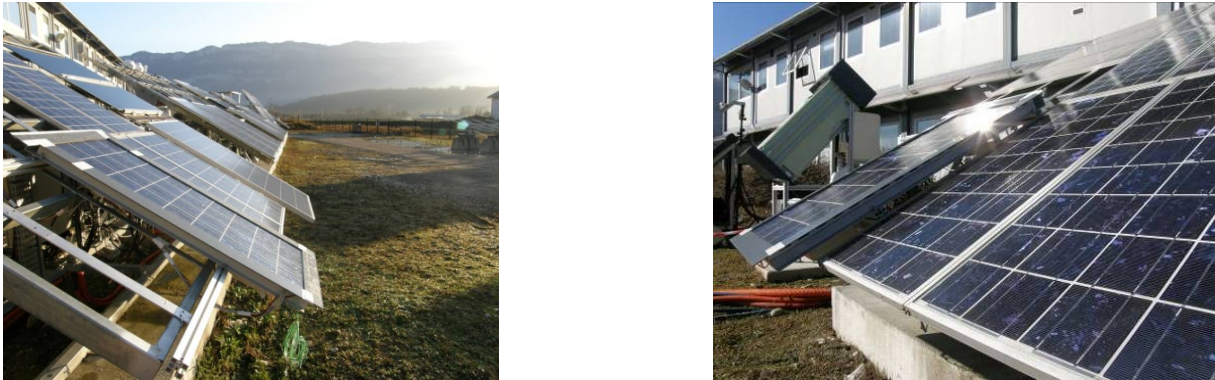
Figure 4.35 : Site expérimental de l'unité du CEA au Bourget-du-lac d'essais en ensoleillement réel du module LiPV.
