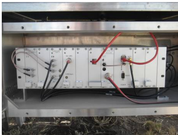
FIGURE 4.28 – Photo de l'électronique de la station autonome, caisson ouvert.
