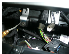
FIGURE C.5 – Photo du branchement du câble coaxial derrière la console auto-radio
