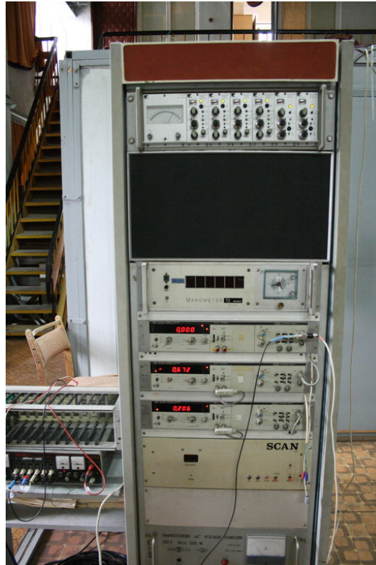
Figure 5.9. Photo des conditionneurs des capteurs de pression entrée de veine et de pression différentielle convergent
