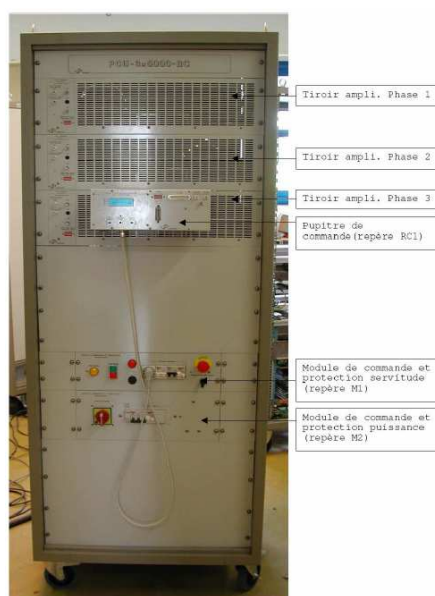
FIGURE 5.4 – Amplificateur de puissance du banc de test universel du G2ELab
