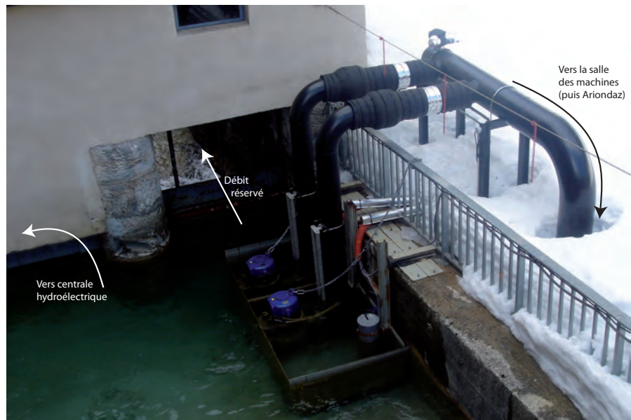
Photo 7.19 : Les pompes pour l'enneigement de Courchevel installées dans l'ouvrage de la concession hydroélectrique de la chute de Bozel (cliché : P. Paccard, le 03/04/2009)
