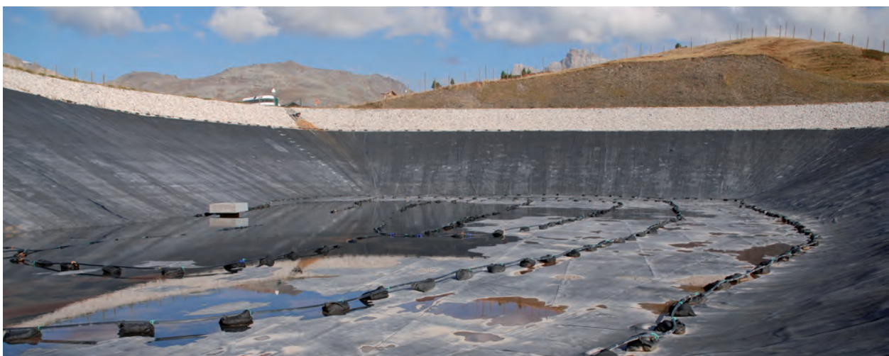
Photo 8.1 : Dispositif de bullage en fond de retenue à Méribel, Savoie ( cliché : P. Paccard, le 28/09/2009)
