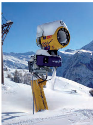
Photo 5.4 : Enneigeur monofluide à poste fixe, monté sur tour
