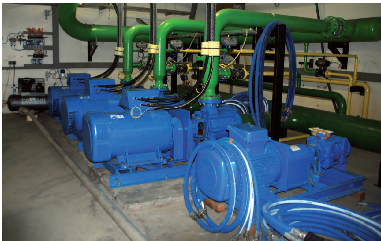
Photo 7.6 : Les pompes de la salle des machines du Biolley (cliché : P. Paccard, le 29/09/2009). Elles permettent d'envoyer l'eau sous-pression vers les réseaux d'enneigeurs.
