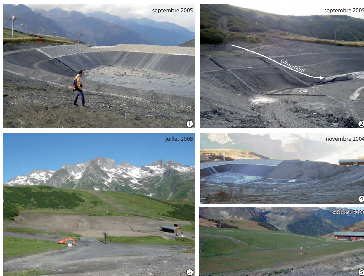
Figure 3.27 : Le glissement de la retenue de Baudin (Valmorel, Savoie) (1 et 2) et la réhabilitation du site (3, 4 et 5) (clichés : DDAF 73 [1, 2, 4 et 5] ; P. Paccard [3])
