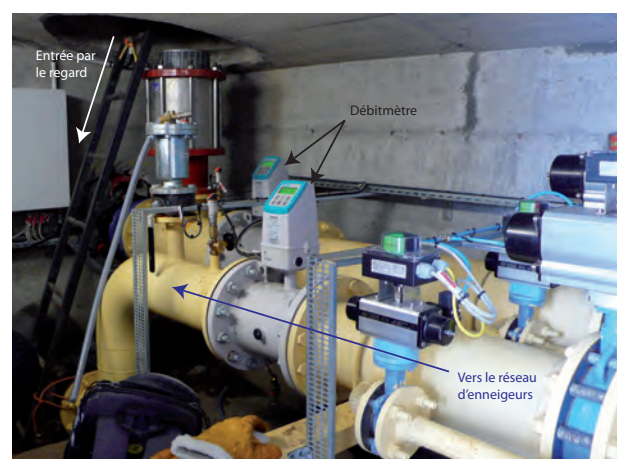
Photo 5.8 : Vue de l'intérieur de la chambre des vannes des Estaris (cliché : P. Paccard, le 09/04/2009)
