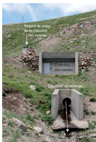
Photo 5.7 : Vue de l'extérieur de la chambre des vannes des Estaris (cliché : P. Paccard, le 09/07/2009)
